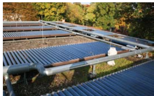
REFRIGERACIÓN SOLAR. Detalle del sistema de refrigeración solar que tiene instalado la universidad de Psiquiatría de Friburgo.
